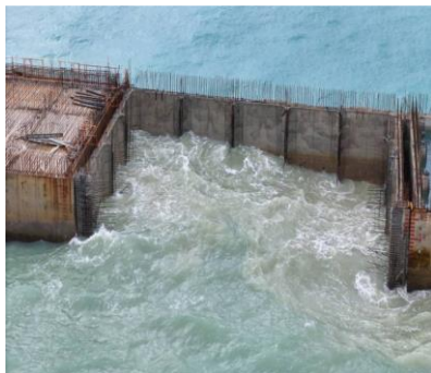
Caisson No.5 ชำรุดเสียหาย
