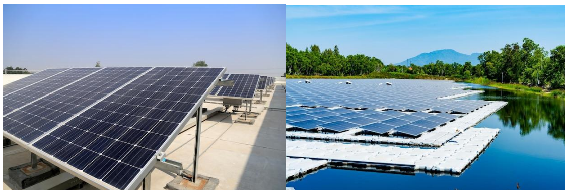
รูปที่ 4-3 ตัวอย่างการติดตั้งระบบผลิตไฟฟ้าพลังงานแสงอาทิตย์ (Solar Cell System)
